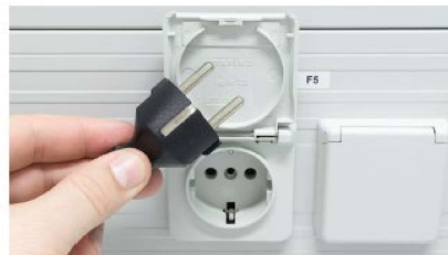
Schutzkontaktsteckdose (Absicherung 16 A) Befindet sich 2 m vom Stellplatz zur Maschine
